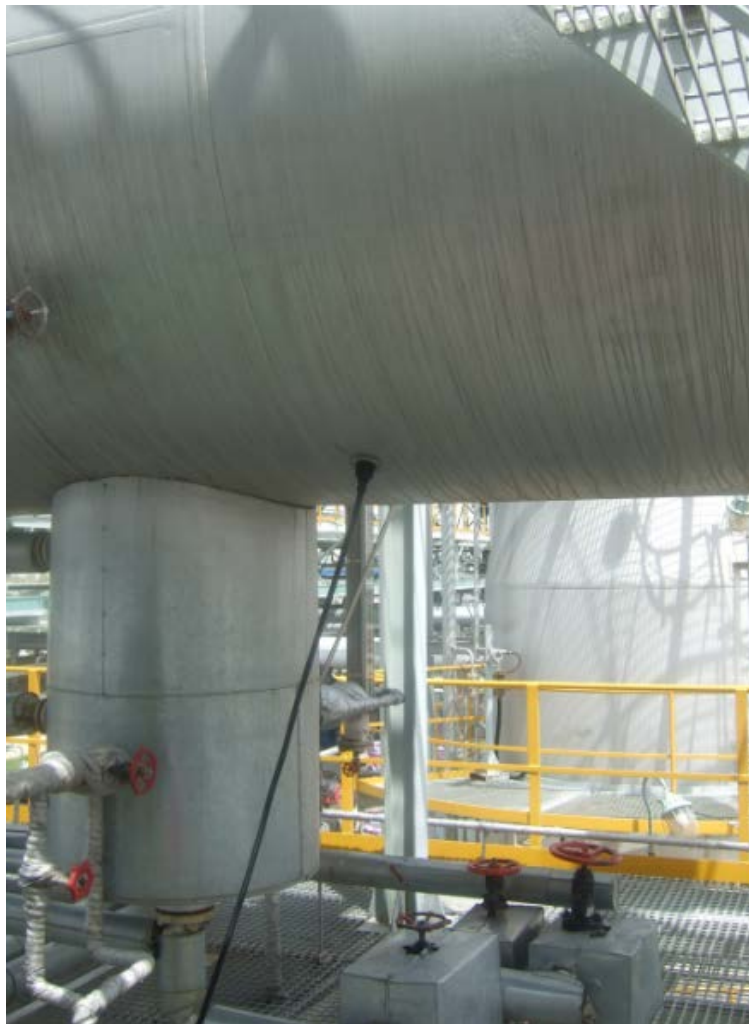
现场罐体全图
